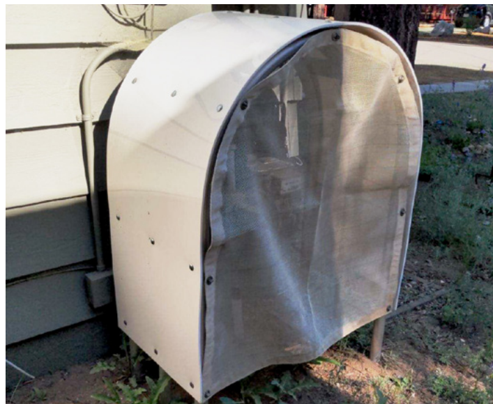
Medidor con refugio de nieve
